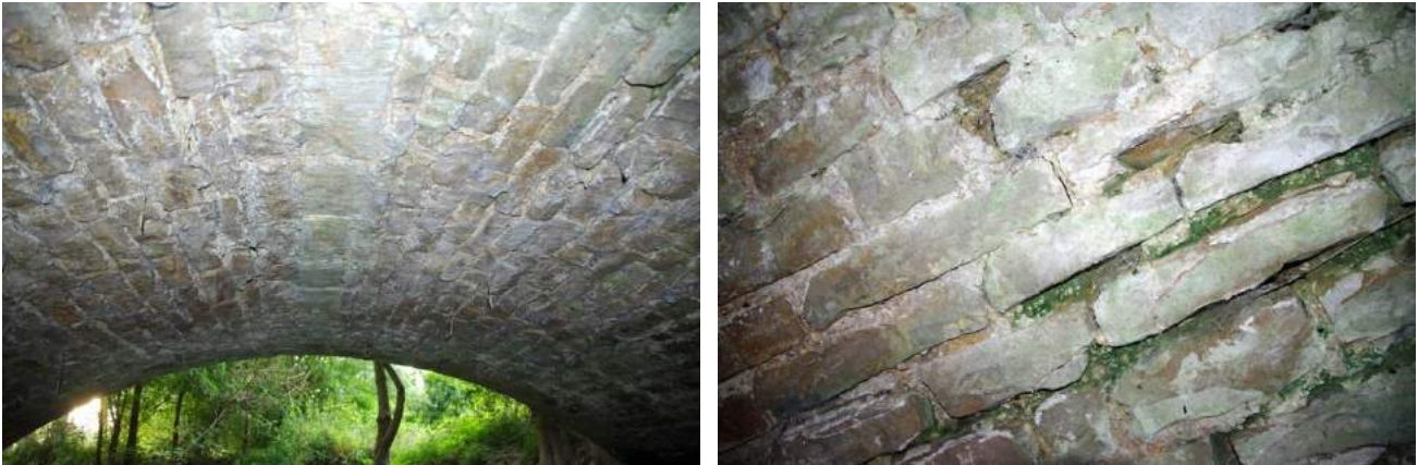
Pont voûté sur le Mignon (lieu-dit les Brédoires au nord du site) dont le tablier jointé ne présente pas d'anfractuosités favorables (12/09/2016)
