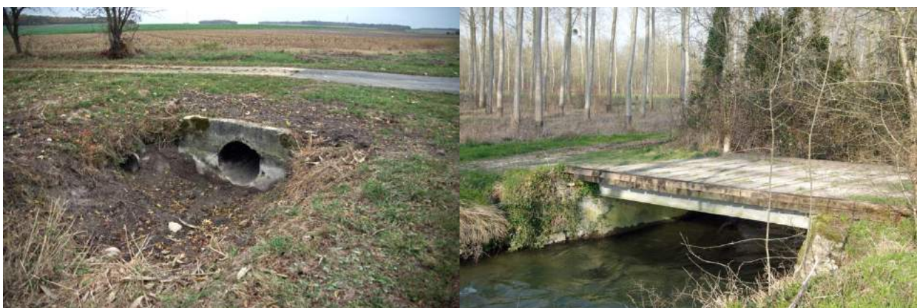
Buse en béton et pont en bois : deux ouvrages sans potentialité d'accueil pour les chiroptères
